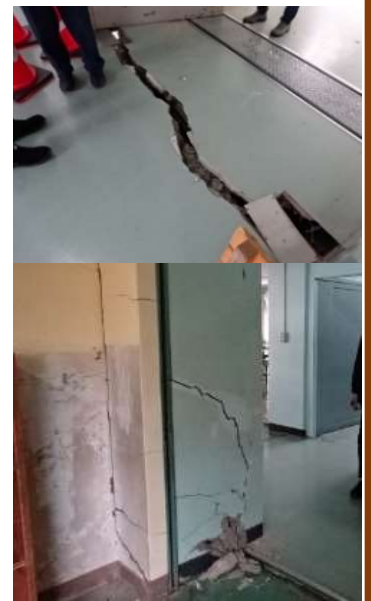
坂井輪中学校 被害状況
