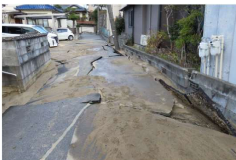
私道路の隆起・陥没
