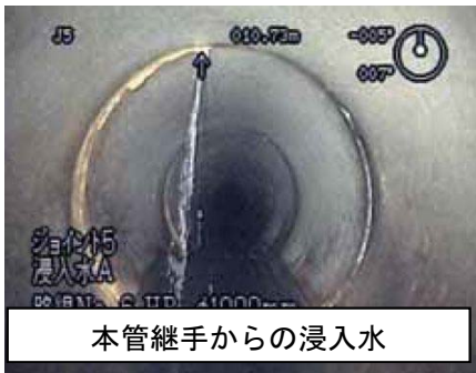
管渠の老朽化状況
