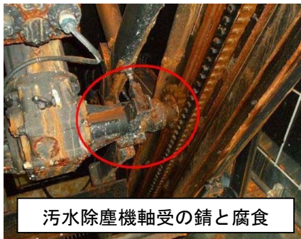
施設の老朽化状況
