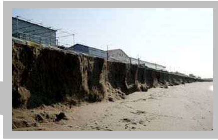
関屋浜海水浴場の侵食状況（平成18年9月）
