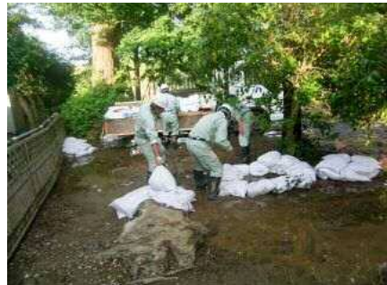
平成23年7月洪水時の漏水発生状況 (江南区蔵岡地区)
