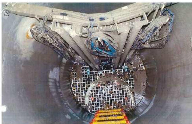
写真②：新潟市西区的場流通地内 (マンホールがずれて土砂が流入)
