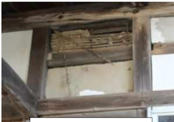
「法淳寺」本堂土壁落下等
