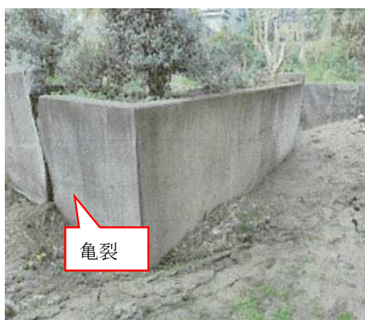
建物裏側土留めの亀裂
