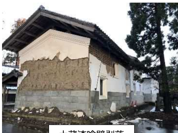
土蔵漆喰壁剥落
