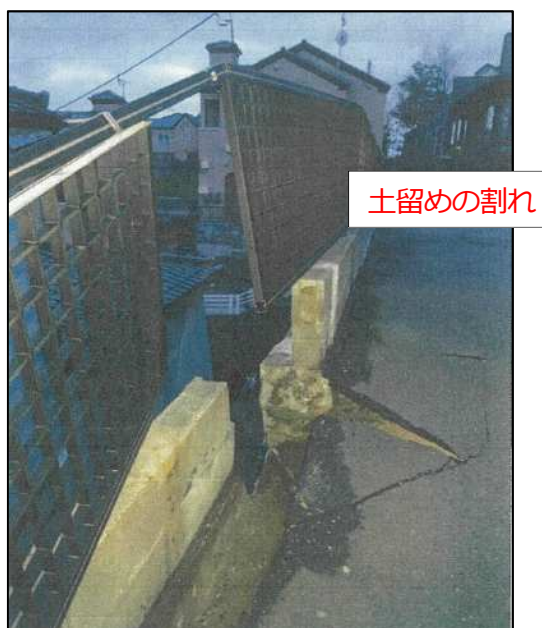
写真②：避難指示が出ている地域の被害状況
