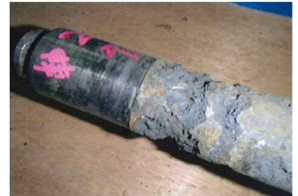
ポンプ主轴の腐食
