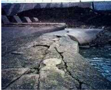
第二床固 水叩き部のひび割れ状況
