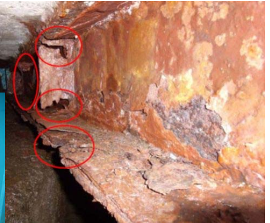
補剛材等の腐食状況 (通行止めを実施した橋梁)
