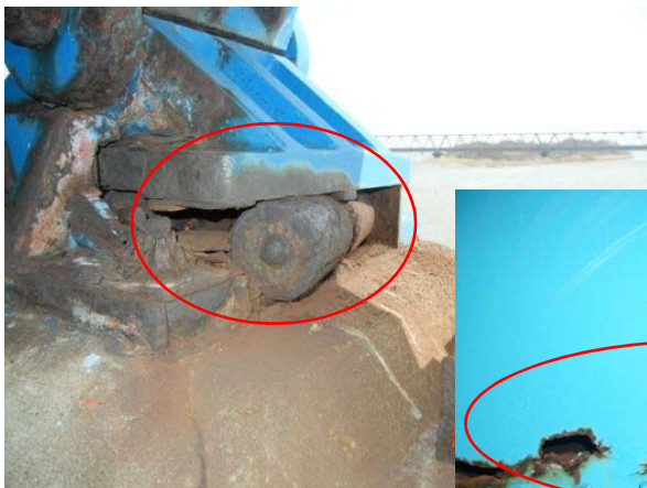
沓の損傷状況 (歩道専用橋梁)
