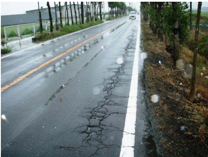
路面クラックの状況 路線: 主要地方道 新潟五泉間瀬線
