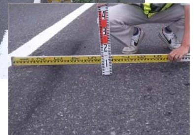
轍掘れの状況 路線: 主要地方道 新潟港横越線
