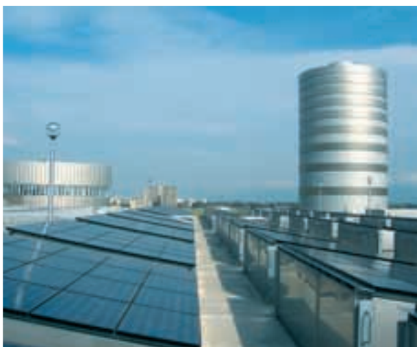
太陽光パネル(信濃川浄水場)
