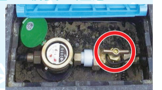
▲メーターボックス内の止水栓
