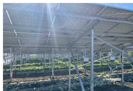
露地上部の太陽光パネル
