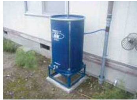
【貯留タンク設置例】
