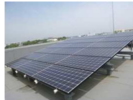
機械式駐輪機の格納庫屋上に設置された 太陽光パネル
