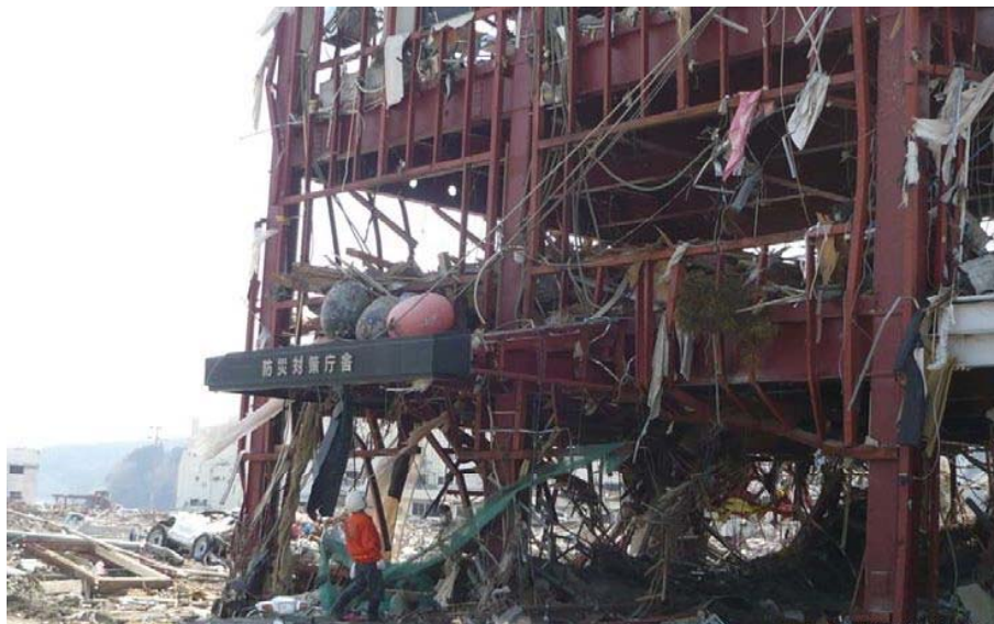
津波におそわれ鉄骨がむき出しとなった南三陸町防災対策庁舎(平成23年東日本大震災) 出典:(財)消防科学総合センター
