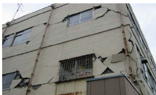
新潟県中越地震による建物被害
