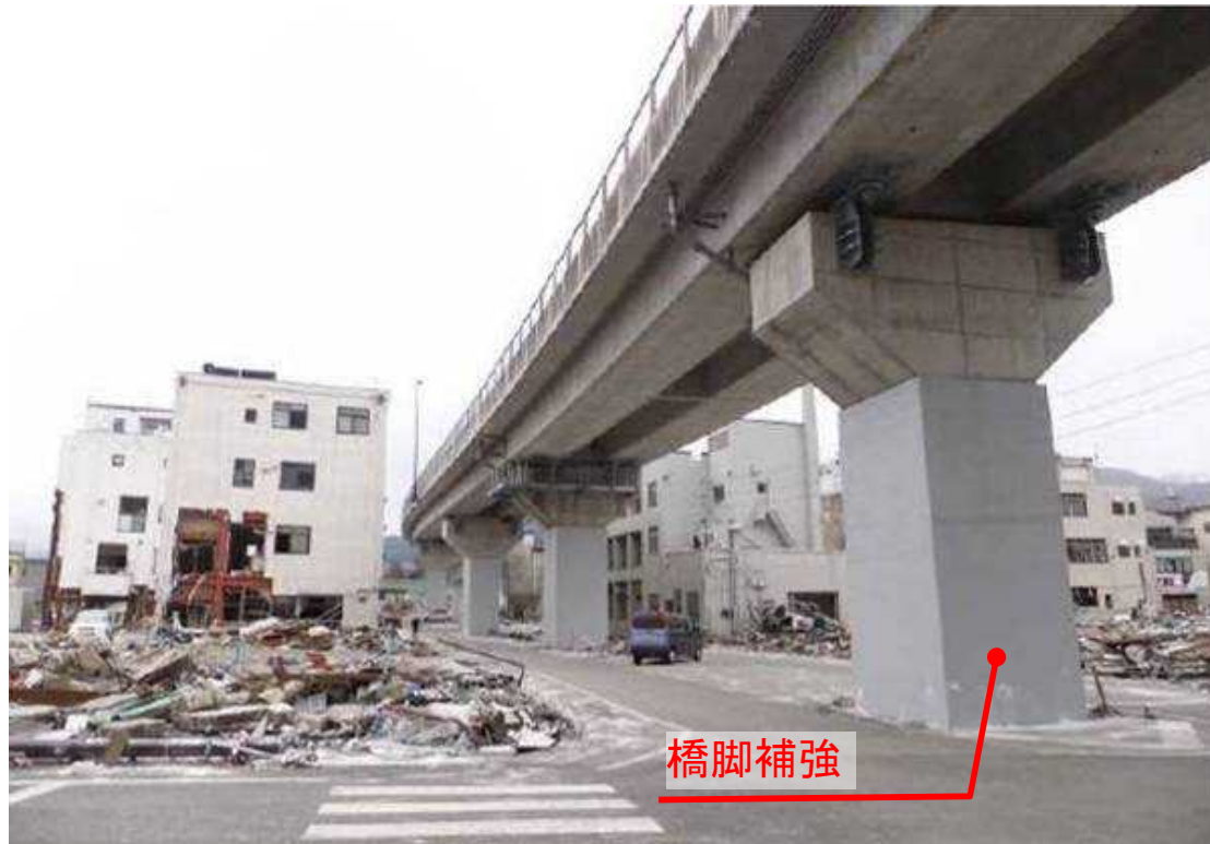
国道45号 (観測震度:震度6弱)
