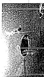
<循環水系配管穴損箇所(拡大図)>
