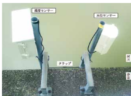
写真4.2 濁度センサー及び水位センサー
