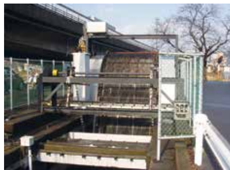
■図-23 姥ヶ山排水路除塵機
