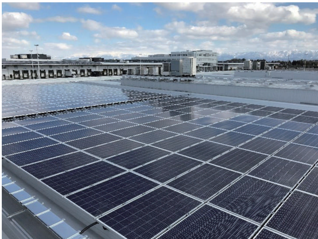
写真「新潟市中央卸売市場に設置した太陽光パネル（新潟スワンエネルギー）」
