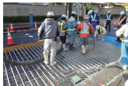
車道融雪設備設置状況
