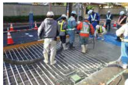
車道融雪設備設置状況
