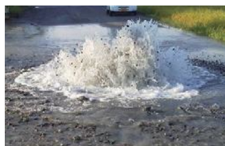
▲水道管が腐食して漏水した道路
