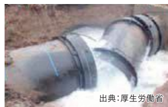
▲東北地方太平洋沖地震による送水管の抜け出し(宮城県) 出典:厚生労働省
