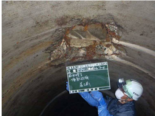
破損した下水道管路
