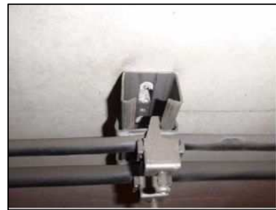
附属物のボルトのゆるみを確認する新技術
