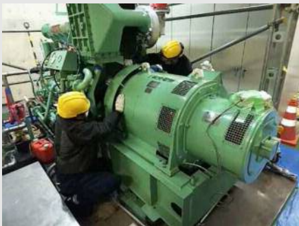
自家用発電機定期整備
