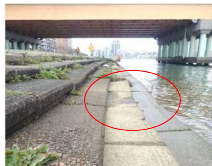
護岸ブロックの沈下
