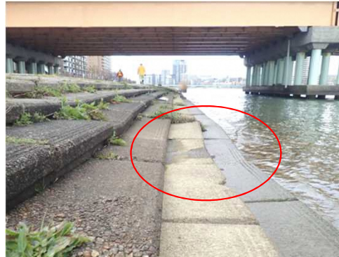
護岸ブロックの沈下
