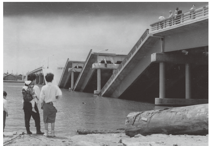
写真2 落下した昭和大橋（信濃川左岸から）
