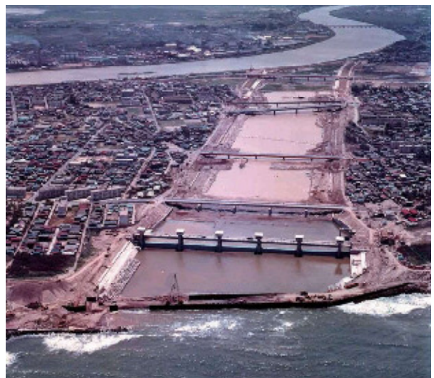
掘削がほぼ完了した関屋分水路 昭和46年6月 北陸地方整備局信濃川下流河川事務所提供
