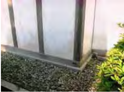
写真 1-12 下屋土台の腐朽
