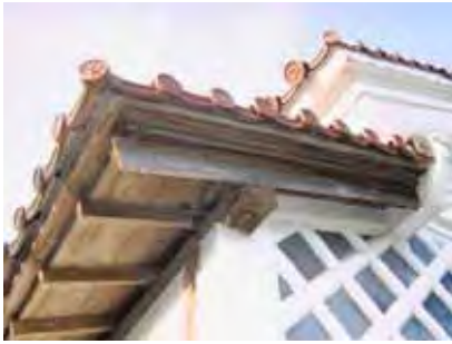
写真 1-20 下屋木部の染み
