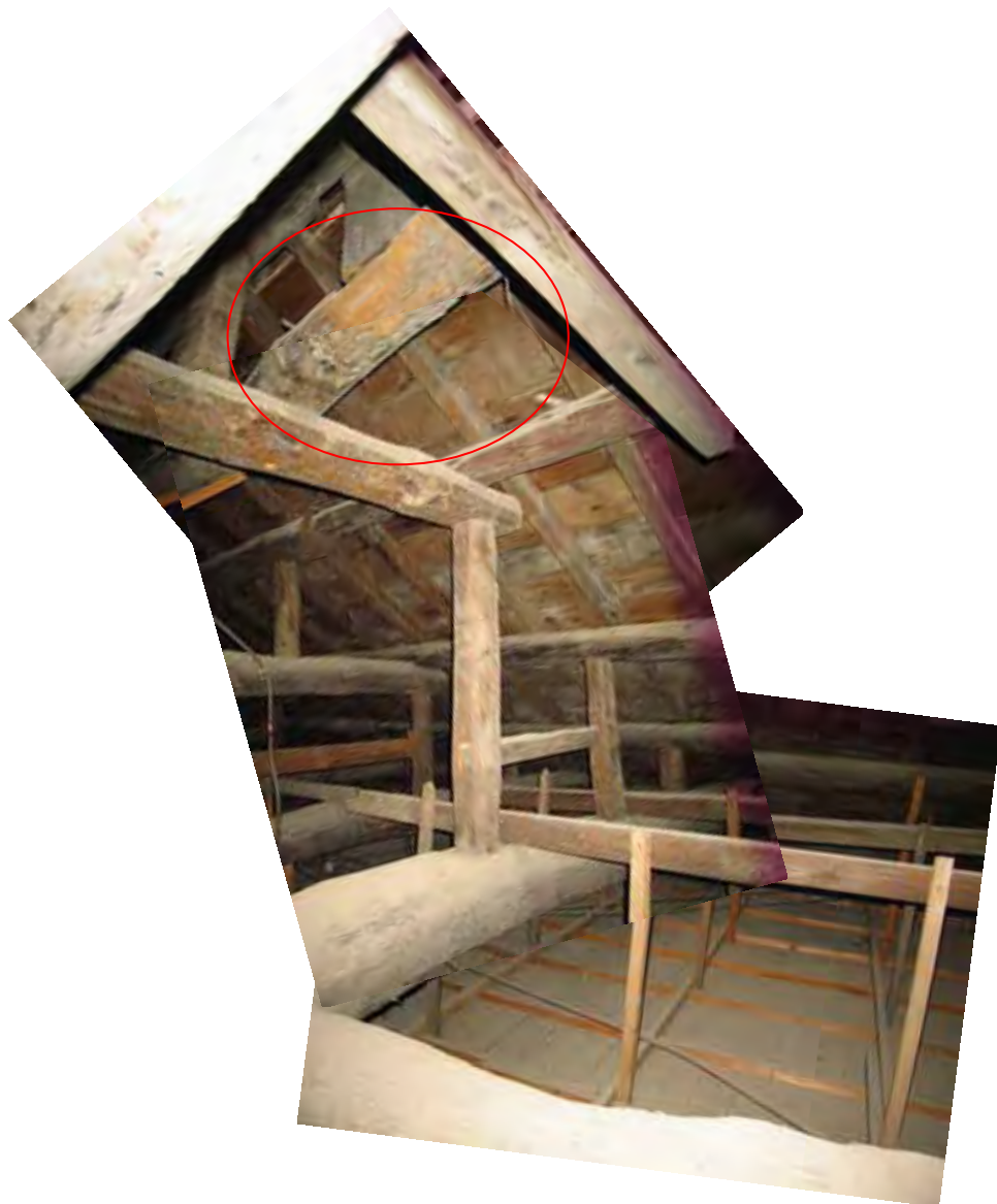
写真 1-11 小屋梁表面の腐朽
