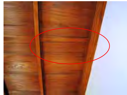
写真1-6 天井板の亀裂
