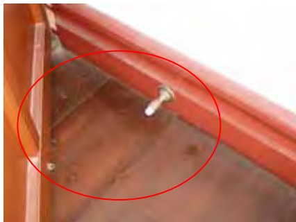
写真1-7 内部建具あおり止めの欠損
