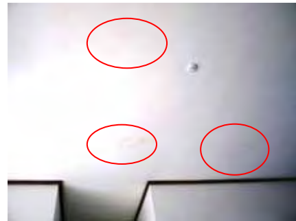
写真1-4 中央通路天井の染み
