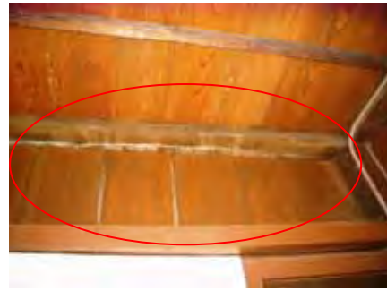
写真 1-10 塔屋天井，小壁の染み
