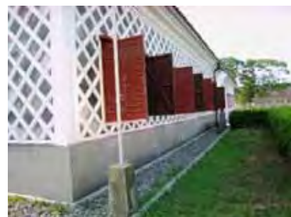
写真 1-19 ベンガラによる汚れ
