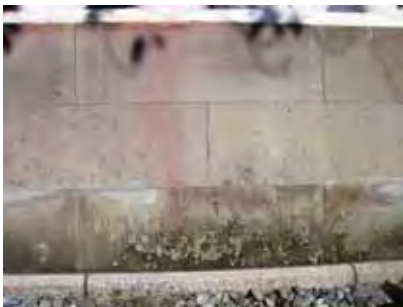
写真 1-14 基礎布石の汚れ
