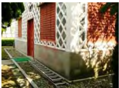
写真 1-18 ベンガラによる汚れ
