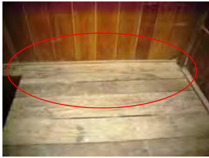
写真 1-9 塔屋下層床の染み
