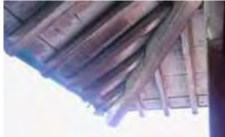
写真 1-24 塔屋軒裏の腐朽
