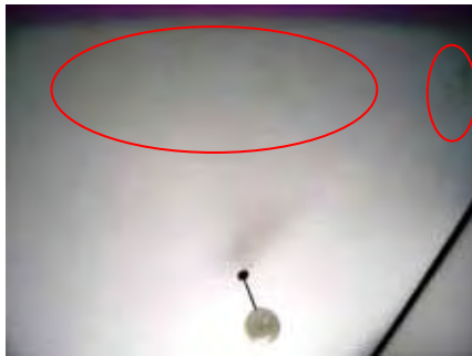
写真1-3 中央通路天井の染み
