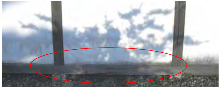
写真 1-15 漆喰面の汚れ
