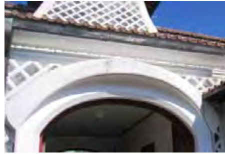
写真 1-21 アーチ部の汚れ
