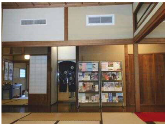
図 4-37 冷房の吹き出し口
