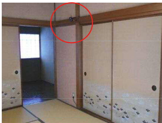
図 4-54 防犯カメラ設置の様子 2
