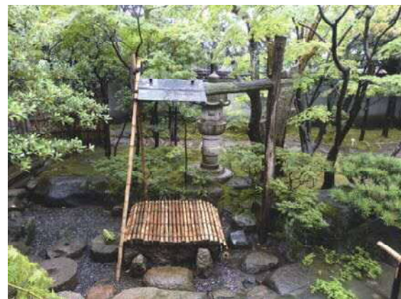
図 4-4 劣化が進行している井戸屋形
