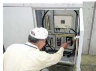
配電盤の点検
