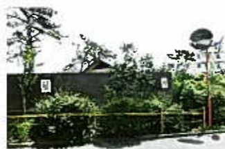
危険なブロック塀
