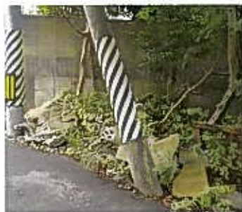
崩れたままのブロック塀
