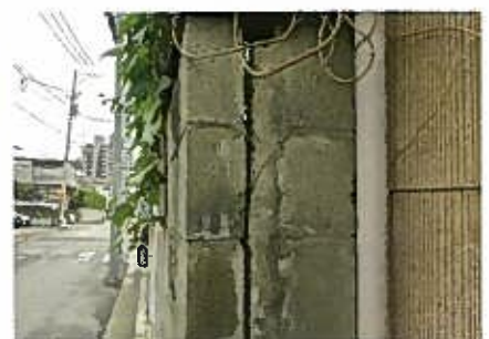
傾きのあるブロック塀
