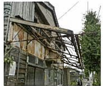
朽ちた廃屋のひさし
