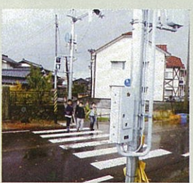
設置された「信号機」子ども達が、通学に利用しています。
