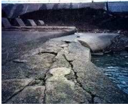
第二床固 水叩き部のひび割れ状況
