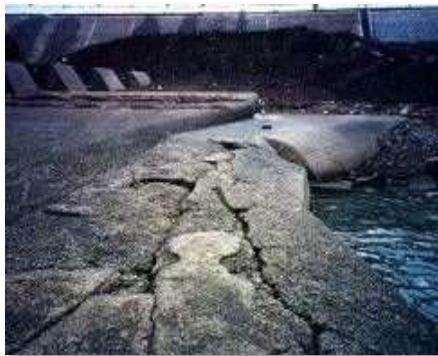
第二床固 水叩き部のひび割れ状況
