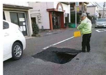
【道路陥没の状況】
