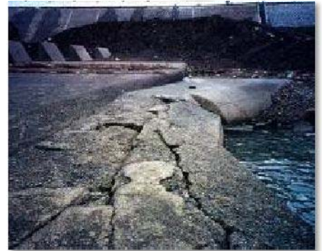
第二床固 水叩き部のひび割れ状況
