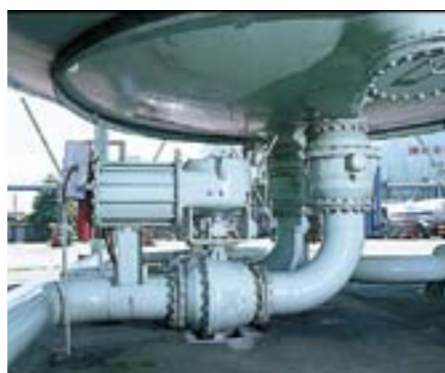
ESV(緊急ガス遮断装置)
