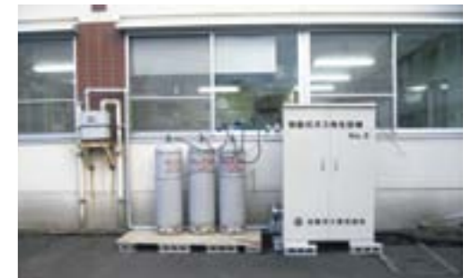
30m 3 /hタイプを設置 (新潟県中越地震)
