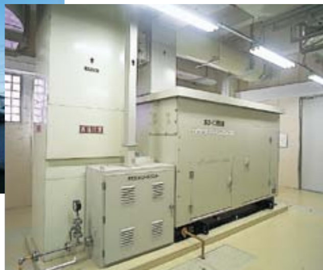
非常用発電装置 (200kWガスタービン)
