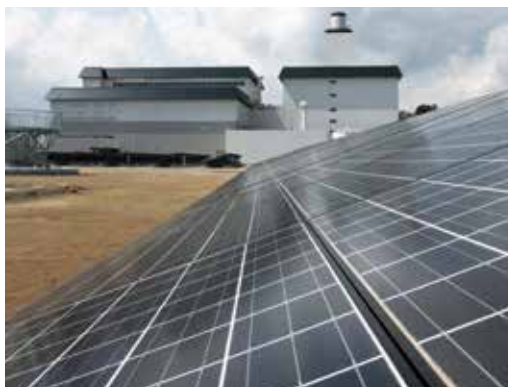
仙台太陽光発電所(宮城県七ヶ浜町)
