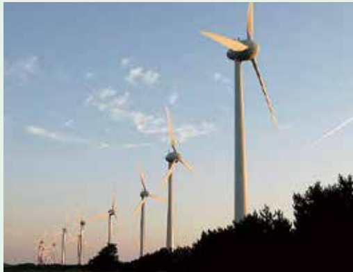
能代風力発電所(東北自然エネルギー開発/秋田県能代市)
