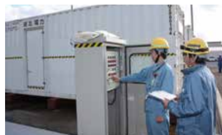
大容量電源装置を用いた電源確保訓練
