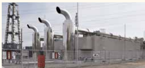
女川原子力発電所に設置した大容量電源装置3台（出力1台：5,000kVA）
