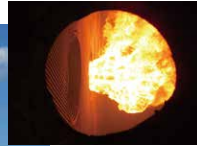
2号機ボイラ点火
