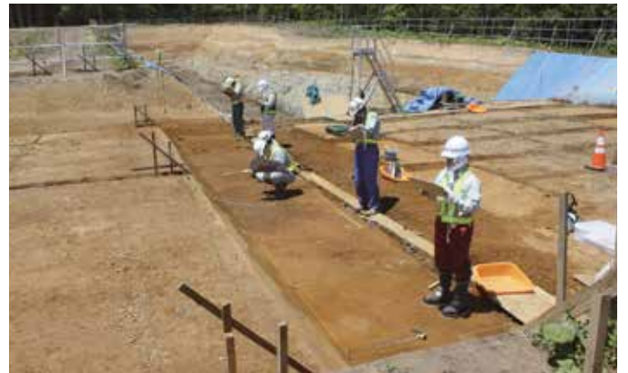
断層破碎部の真上を段階的に水平に掘削し、横ずれ断層特有の構造(亀裂等)の有無を確認
