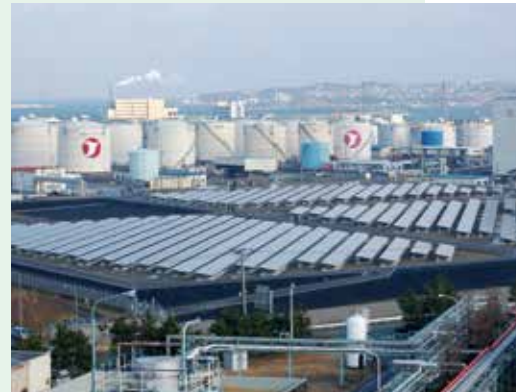
八戸太陽光発電所(青森県八戸市)
