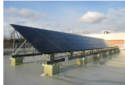
【沼垂小・太陽光発電設備の例】
