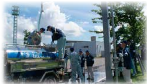
給水車用常設注水設備
