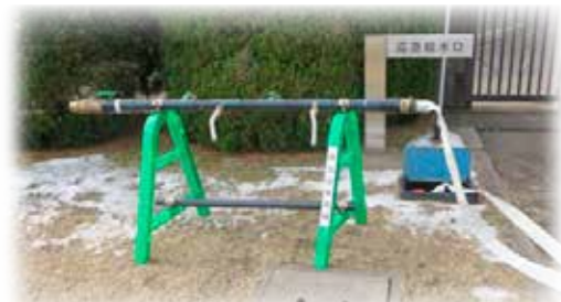
応急給水設備
