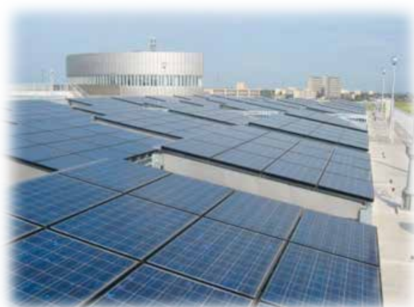
太陽光発電設備（信濃川浄水場）
