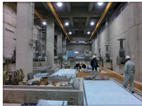
浄水場のポンプも古くなったら新しくします。
