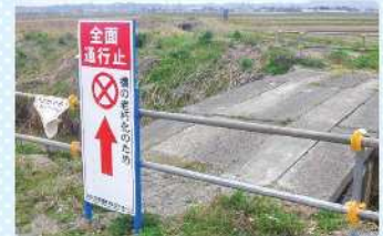
通行止めになってしまった橋
