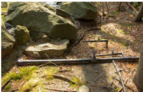
写真 3-87 滝源泉部脇のパイプ露出の様子
