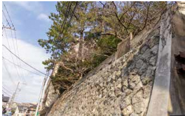
写真 3-95 北西管理用地 越境枝の様子
