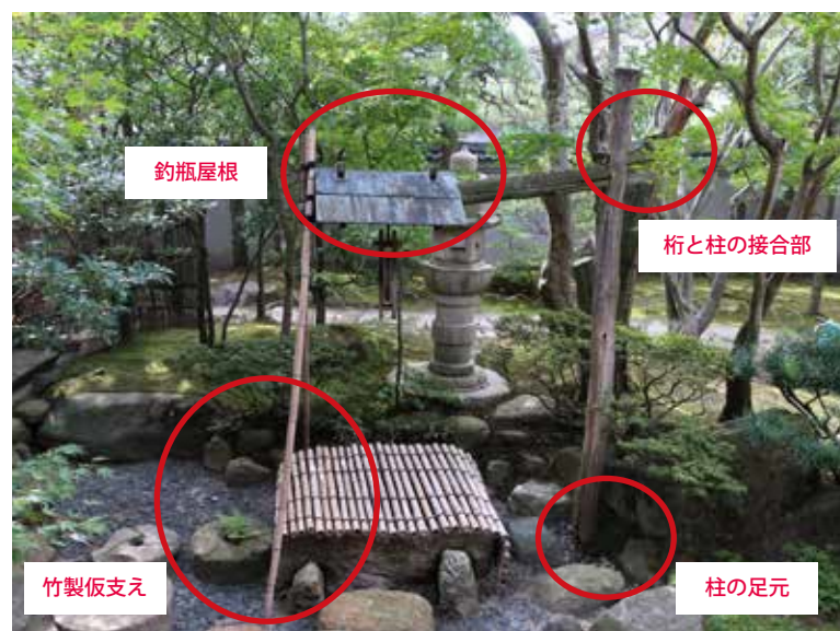
写真 3-96 井戸屋形の破損状況
