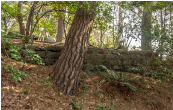
写真 3-94 北西管理用地 土留め石積みの劣化
