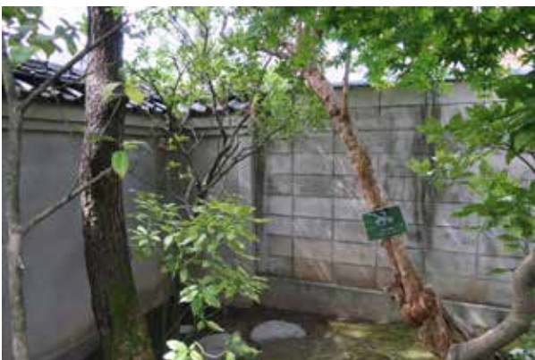
写真 3-60 敷地境界をなすブロック塀 正面の塀と西面との接合部
