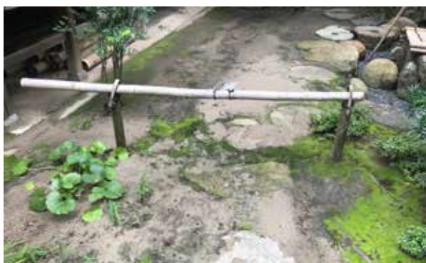
写真 3-70 中庭における土砂流出
