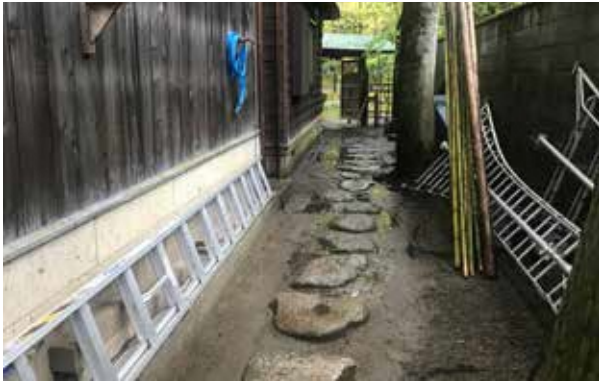
写真 3-92 南東管理用地 排水不良の様子
