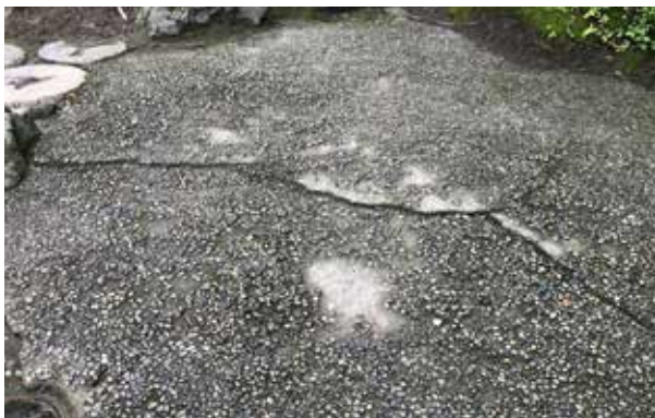
写真 3-80 主庭 洗い出しの劣化の様子
