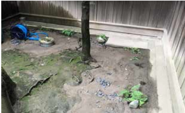
写真 3-68 玄関庭における排水不良の様子
