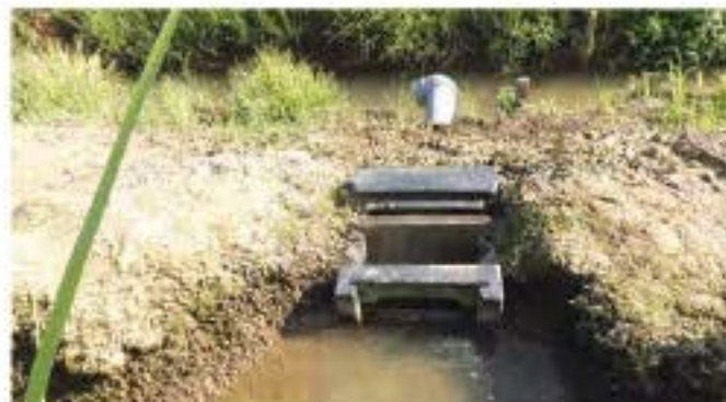
田んぼダム装置の設置状況
