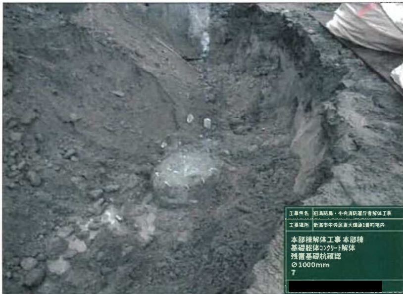
写真区分: 施工状況写真 写真タイトル: 本部棟解体工 事 本部棟 基礎躯体コンクリ ート解体 残置基礎杭確認 10 00mm 7
