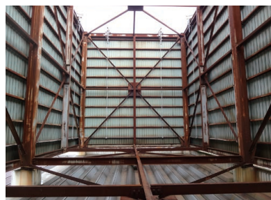
①錆びた屋上広告の鉄骨
