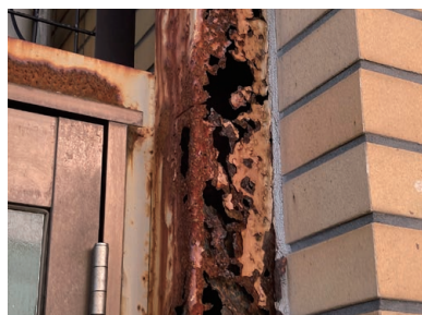
②腐食した野立広告の支柱
