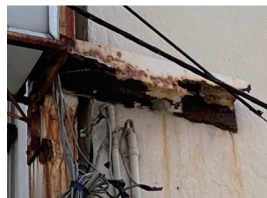
③腐食した突出広告の支持材
