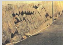
③擁壁の崩壊
