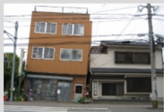
①住宅の沈下・傾斜
