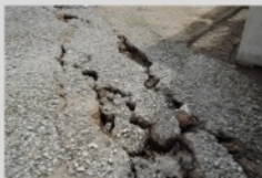
②地盤の亀裂
