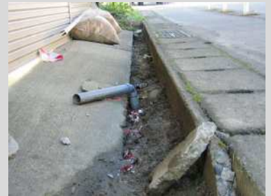
地盤の沈下・段差
