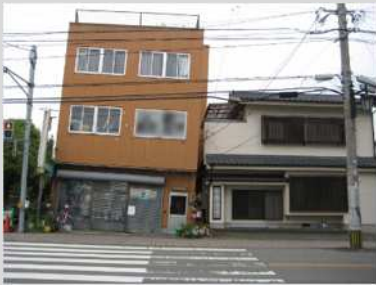
住宅の沈下・傾斜
