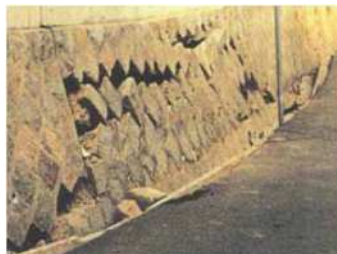
擁壁の不同沈下 (出典：被災宅地の調査・危険度判定マニュアル/被災宅地危険度判定連絡協議会)
