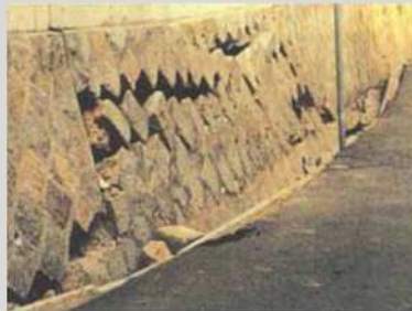
擁壁の不同沈下・目地の開き
