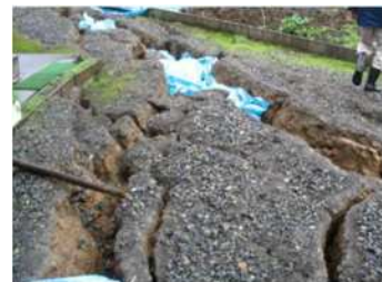
地盤の亀裂 (出典：被災宅地の調査・危険度判定マニュアル/被災宅地危険度判定連絡協議会)
