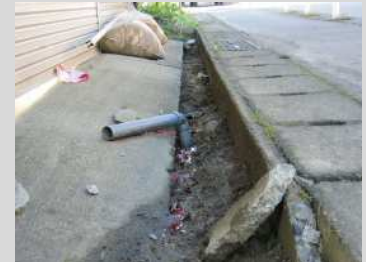
地盤の沈下・段差
