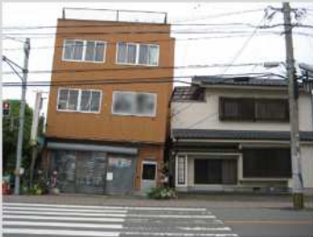
住宅の沈下・傾斜
