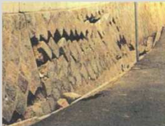
擁壁の不同沈下・目地の開き
