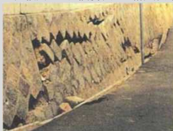
擁壁の不同沈下・目地の開き
