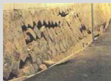
③擁壁の崩壊
