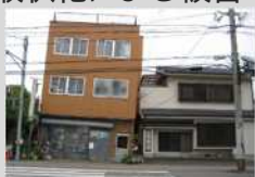
①住宅の沈下・傾斜
