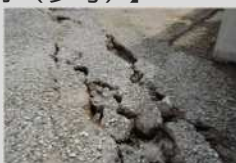
②地盤の亀裂
